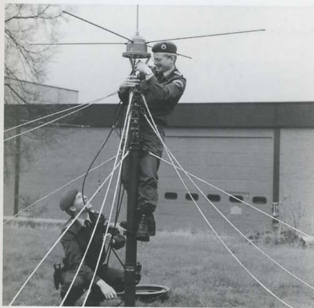
PHW Weiner und Düllberg beim Anschluß des HF-Kabels an die „Aktive Diversityantenne“ 1985.
